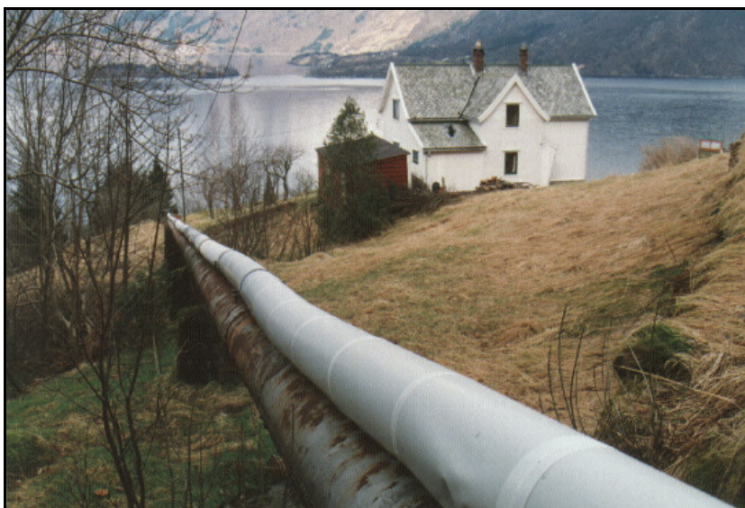
Figur 5. Rørgaten fra inntakسدammen og ned mot bebyggelsen. Drikkevannsledningen er isolert og ligger oppå ledningen til kraftverket. Sistnevnte er gått lekk helt øverst ved inntakسدammen.
