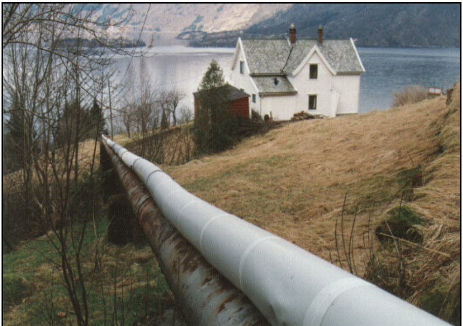
Figur 4. Rørgaten fra inntaksdammen og ned mot bebyggelsen. Drikkevannsledningen er isolert og ligger oppå ledningen til kraftverket. Sistnevnte er gått lekk helt øverst ved inntaksdammen.
