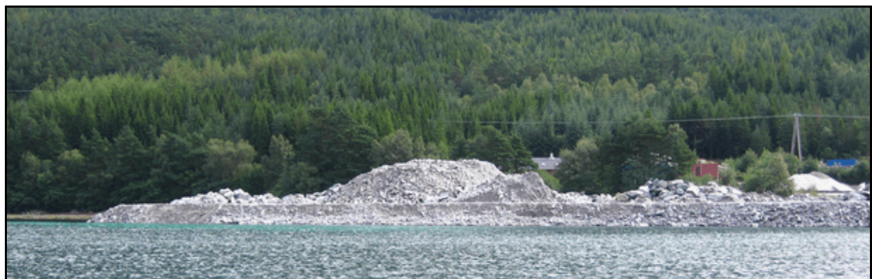
Figur 3. Bilder tatt ved undersøkelsen 16. august 2006 ved utfyllingen ved Husnes Industriområde. Øverst sees fyllingen fra nord, med begynnende "plastring" av fyllingskanten med steinblokker til venstre. I midten sees fyllingen i retning sørover mot SØRAL, og nederst vises fyllingsområdet sett fra vest.
